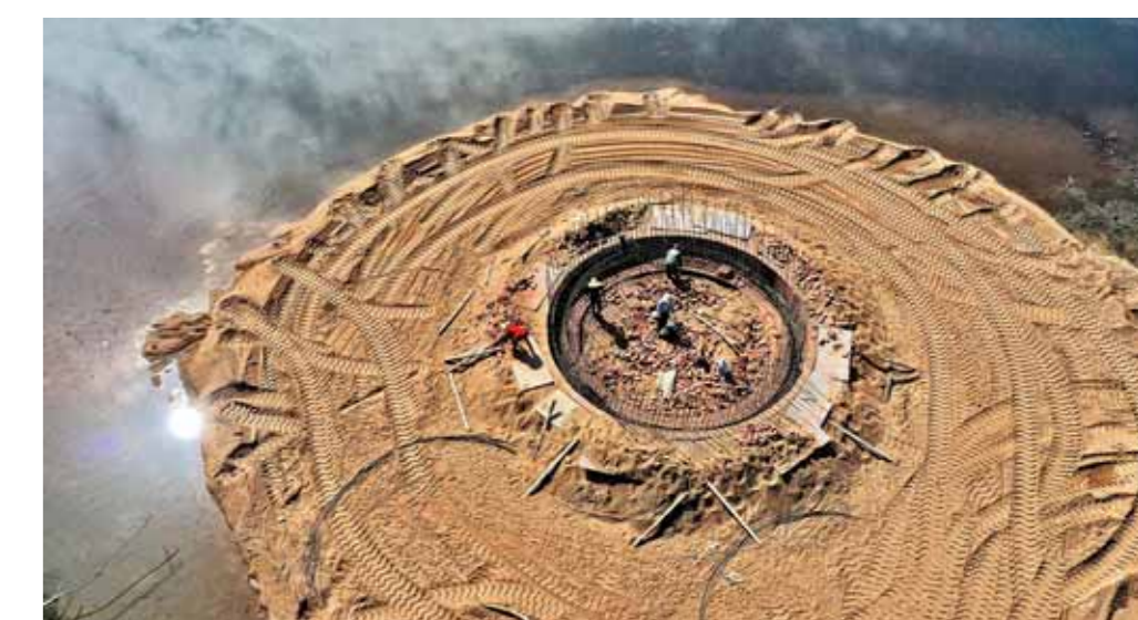
2020年8月竣工验收的江西永丰县恩江镇王家村饮水安全工程 刘驹溪 摄
