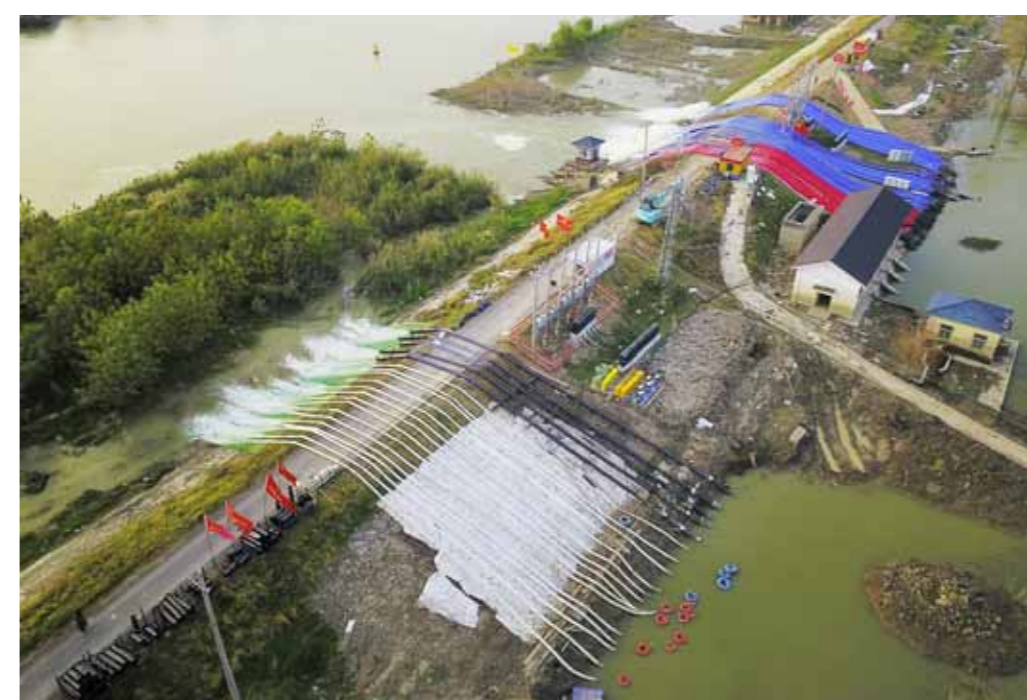
江苏南京市高淳区阳江镇胜利圩架设临时泵站排涝 顾小军 摄
